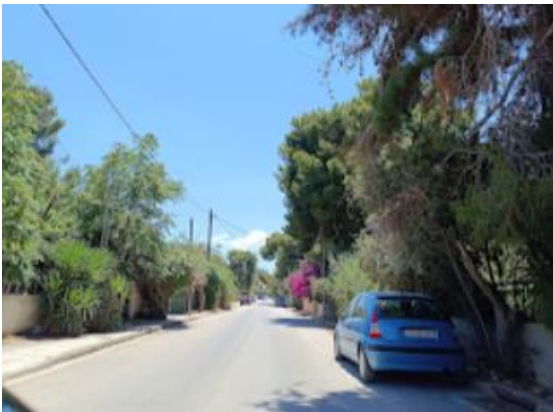
Εικόνα 88. Στιγμιότυπο διαδρομής στην οδό Υπαπαντής με κακοτεχνία στο δεξί πεζοδρόμιο (Πηγή: Επιτόπια λήψη)
