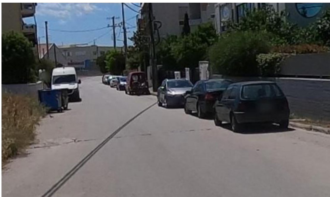
Εικόνα 58. Στιγμιότυπο διαδρομής με κακοτεχνία στο πεζοδρόμιο (Πηγή: Επιτόπια λήψη)
