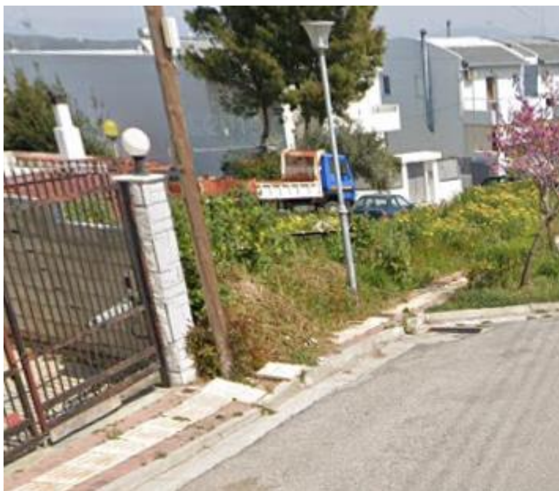
Εικόνα 68. Στιγμιότυπο πεζοδρομίου μικρού πλάτους με κακοτεχνία που επηρεάζει την όδευση τυφλών στην οδό Τριών Ιεραρχών (Πηγή: Επιτόπια λήψη)
