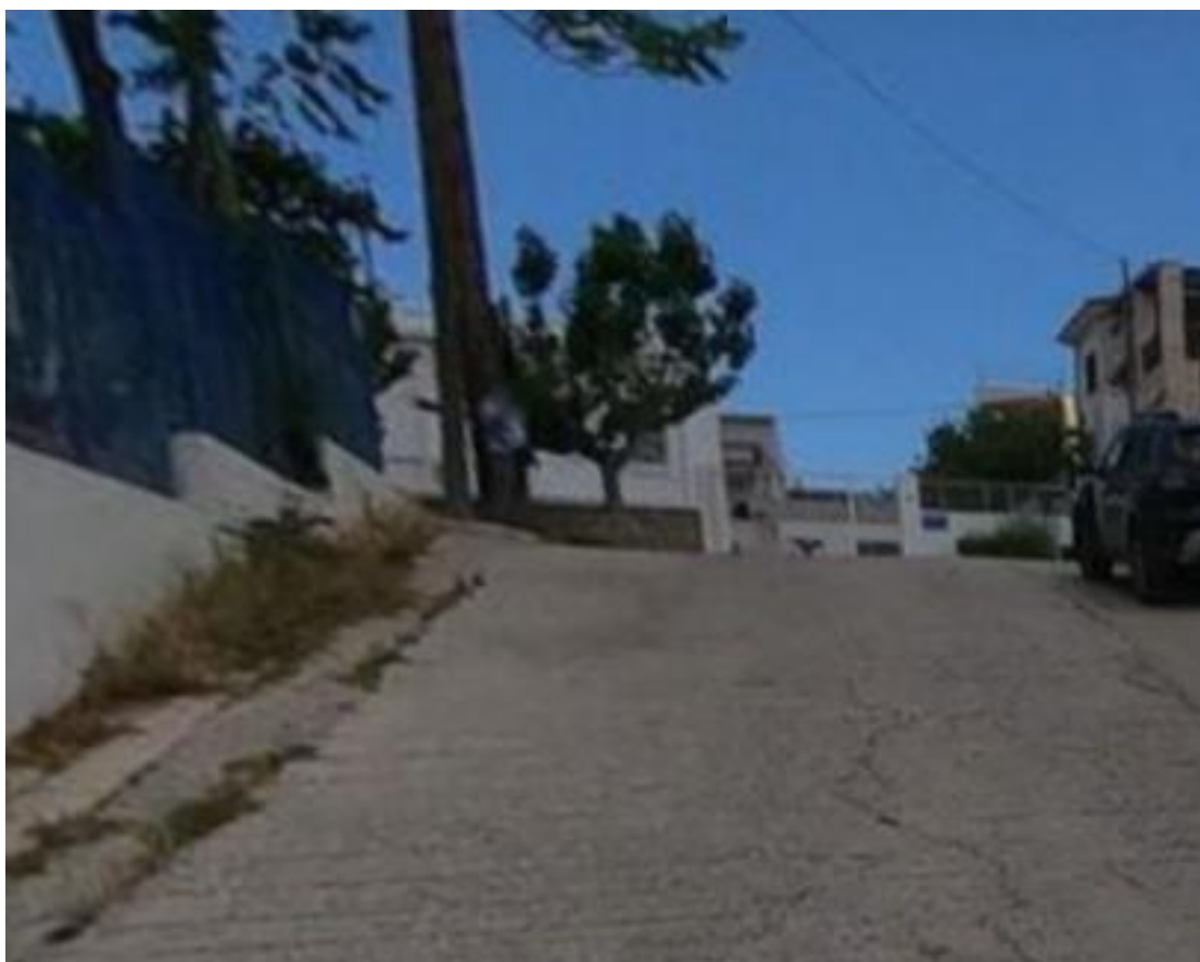
Εικόνα 63. Στιγμιότυπο διαδρομής με κακοτεχνία και κλίση στην οδό Ηλία Μαργέτη (Πηγή: Επιτόπια λήψη)
