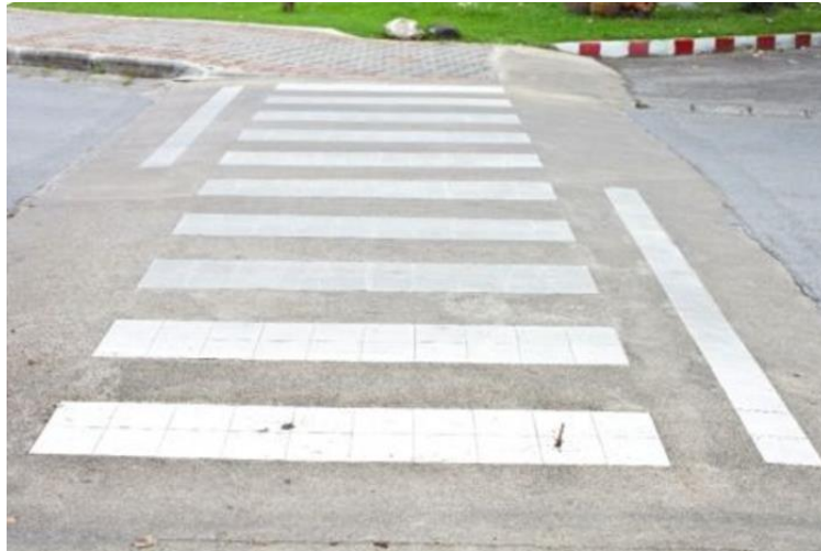
Εικόνα 5. «Επέκταση» πεζοδρομίου σε σαμαράκι για τον περιορισμό της μετακίνησης ΑΜΕΑ σε διαφορετικά επίπεδα
