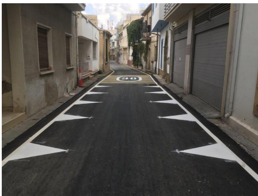
Εικόνα 58. Διαμόρφωση οδού ήπιας κυκλοφορίας με συνύπαρξη πεζού και οχημάτων στο επίπεδο του οδοστρώματος
